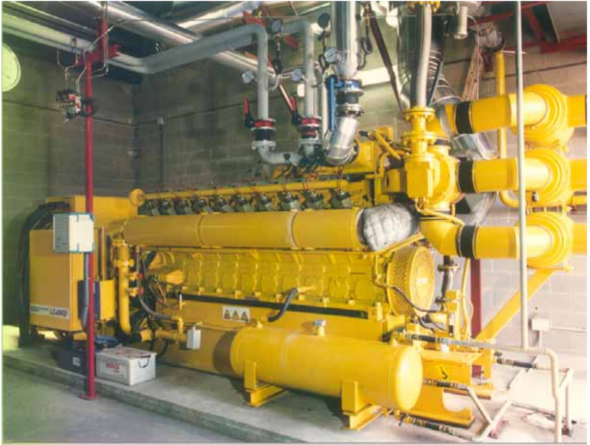
Motogenerador a gas natural en una planta de cogeneración de una Industria Química. (Les Franqueses del Vallés – Barcelona – España)
