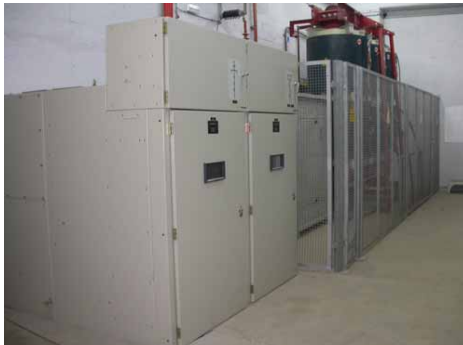
Detalle transformador seco 7.5 MVA 25/11 KV y cabinas 25 KV de carro extraíble en una instalación de tratamiento y reciclado de residuos sólidos urbanos. (Barcelona – España)
