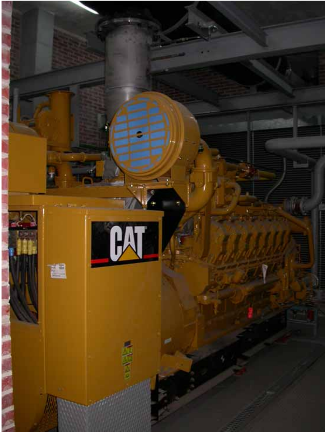
Motogenerador a gas natural de 1180 KW en una planta de cogeneración de una fábrica de productos cerámicos. (Valladolid – España)
