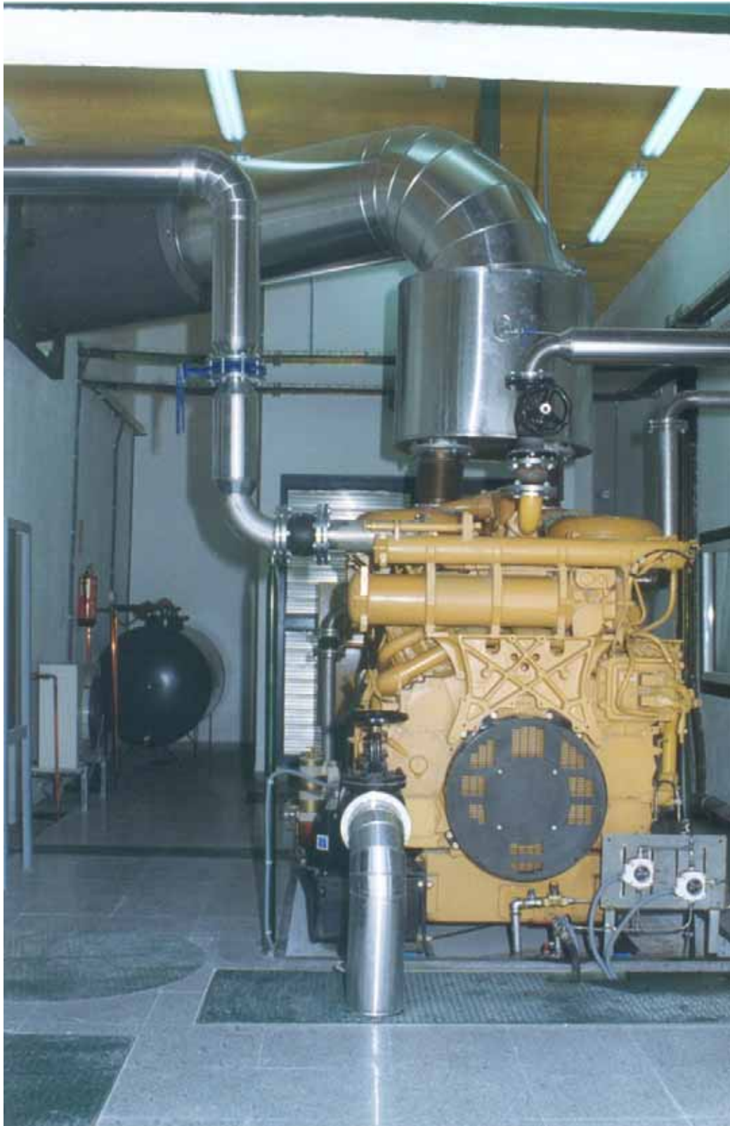
Motogenerador a gasoil en una planta de cogeneración de una Industria cárnica de fabricación de embutidos (Baza – Granada – España)
