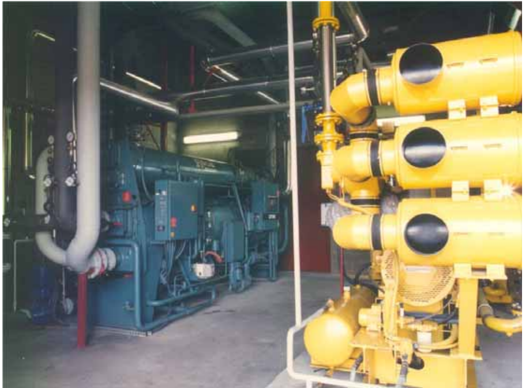
Motogenerador a gas natural y enfriadora de agua por ciclo de absorción en una planta de cogeneración de una Industria Química. (Les Franqueses del Vallés – Barcelona – España)
