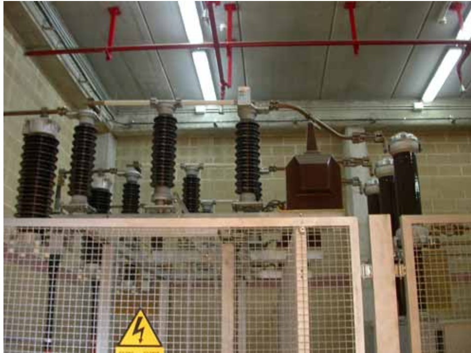
Detalle aparellaje 66 KV en subestación 37 MVA 66/25 KV en una instalación de tratamiento y reciclado de residuos sólidos urbanos. (Barcelona – España)
