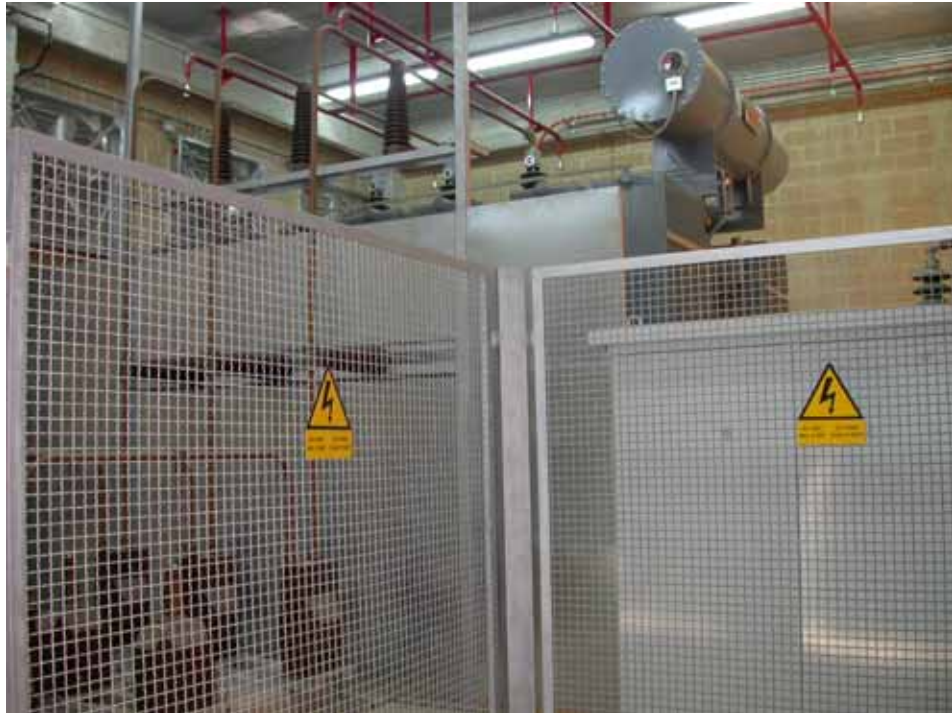
Detalle transformador 37 MVA 66/25 KV en una instalación de tratamiento y reciclado de residuos sólidos urbanos. (Barcelona – España)
