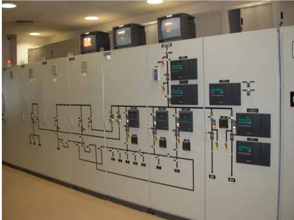
Detalle cuadro de protección y control subestación 37 MVA 66/25/11/0.4 KV en una instalación de tratamiento y reciclado de residuos sólidos urbanos. (Barcelona – España)
