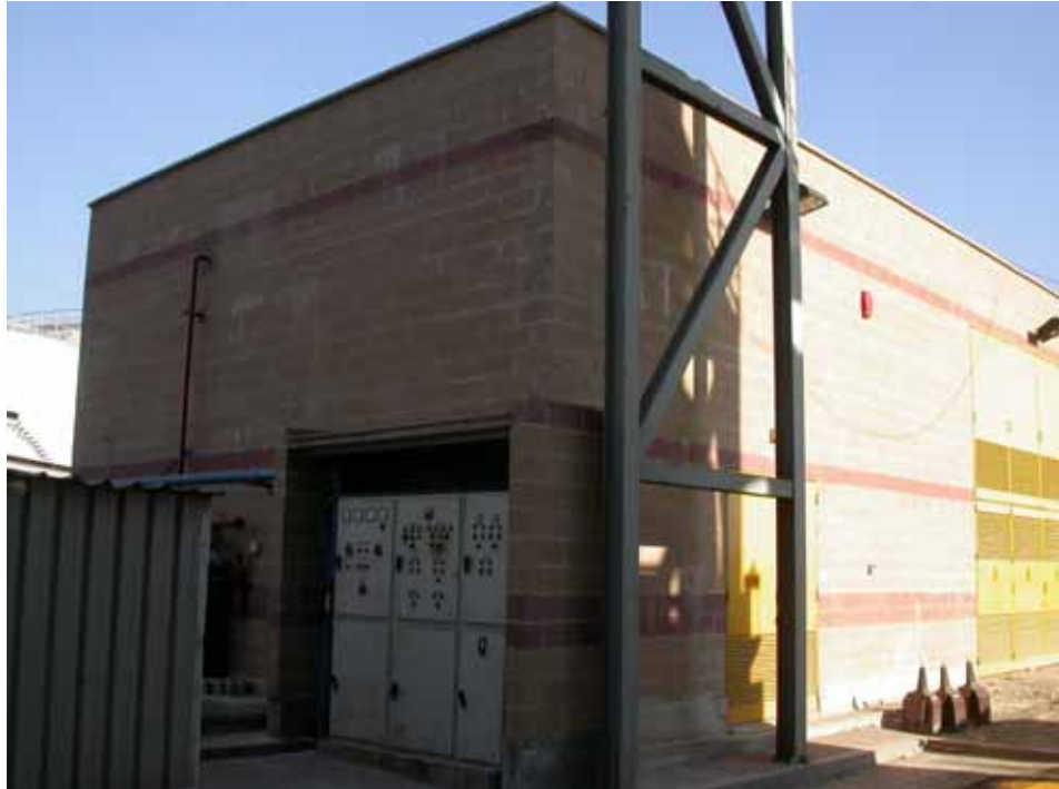
Edificio subestación 37 MVA 66/25 KV en una instalación de tratamiento y reciclado de residuos sólidos urbanos. (Barcelona – España)
