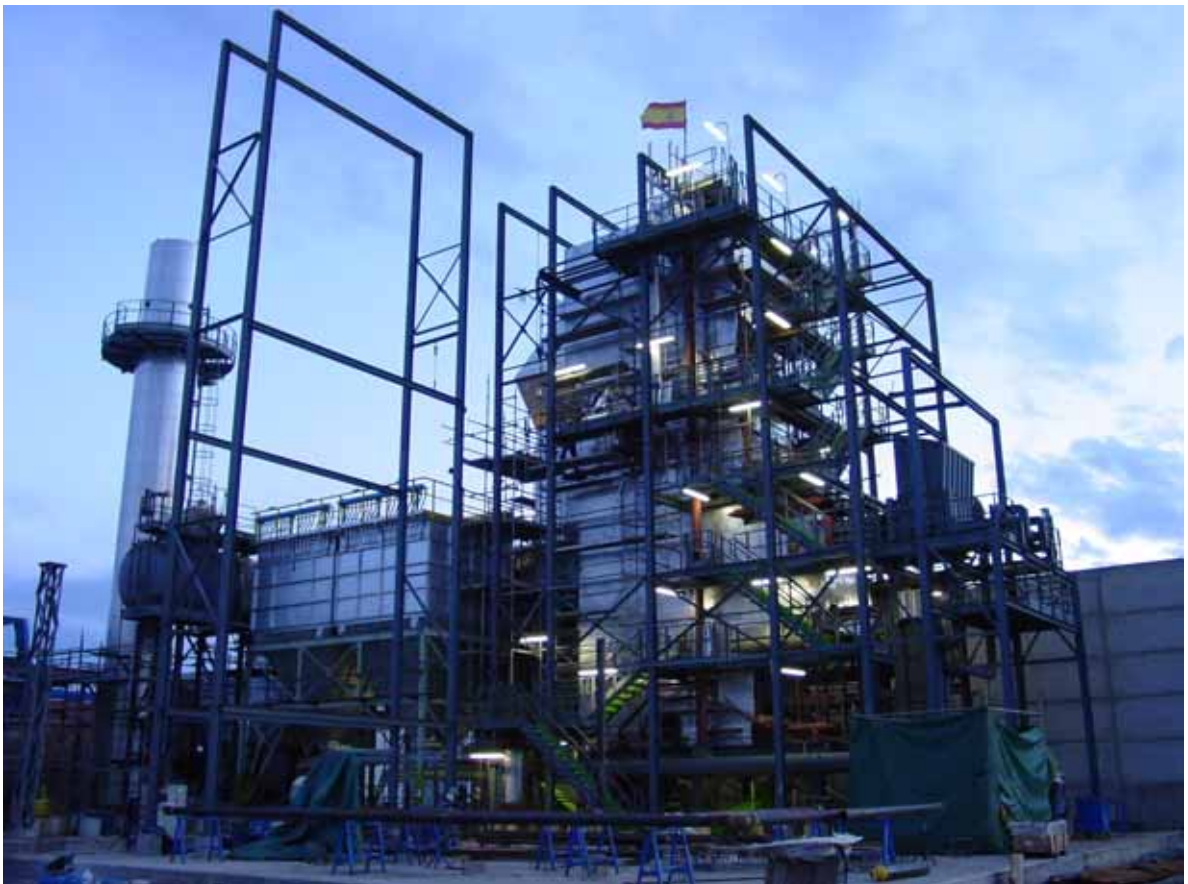
Planta de biomasa con apoyo de gas natural. Potencia eléctrica 9 MWe (Albuixech – Valencia – España)
