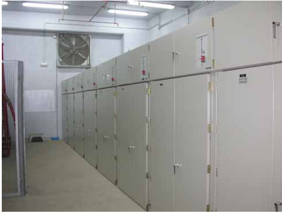
Detalle frontal cabinas 25 KV de carro extraíble en una instalación de tratamiento y reciclado de residuos sólidos urbanos. (Barcelona – España)
