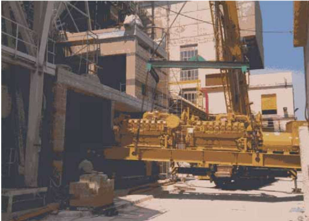
Operación de descarga de un motogenerador a gas natural en una planta de cogeneración de una instalación de tratamiento y reciclado de residuos sólidos urbanos. (Barcelona – España)
